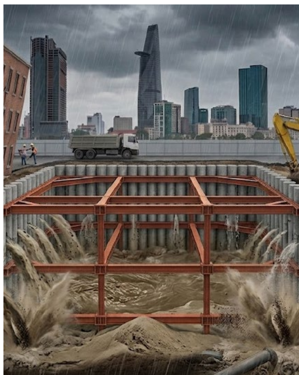
Hình 6 . Sự cố hố đào do mực nước ngầm dâng cao và bơm hạ nước bên trong
